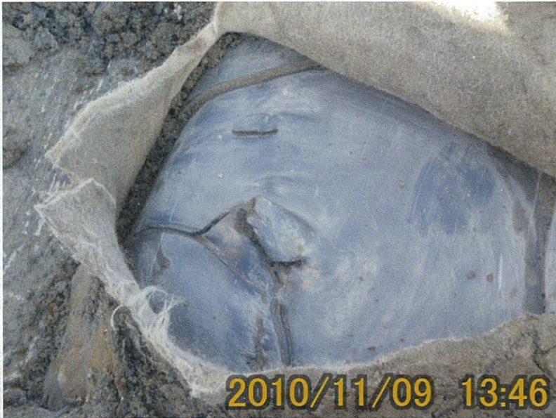
【写真タイトル】①保護 マット展開後損傷箇所写 真
