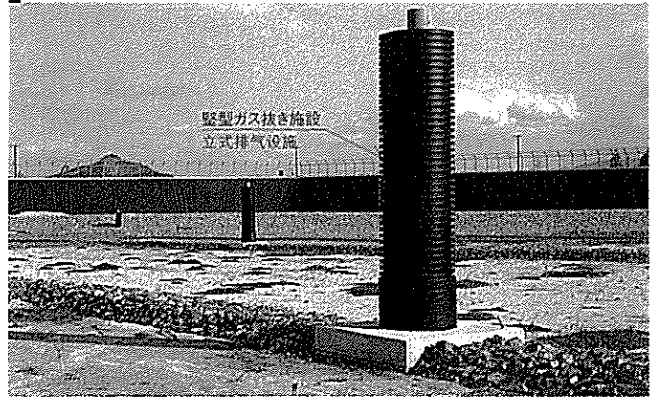
堅型ガス抜き施設 立式排气设施
